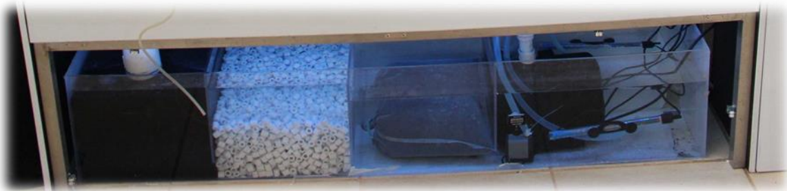
Figura 4-4 Tanque de filtración del sistema en rack.
