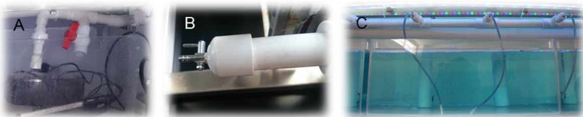
Figura 4-2 Sistema de entrada de agua. Bomba de agua (A), válvula de llegada a tanque (B) y salida con conexión de manguera (C).
