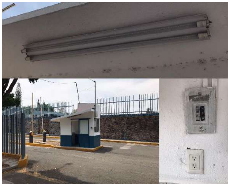
Figura 18 Condiciones y elementos eléctricos de una caseta de seguridad del CU UAQ
