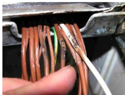
Fig. 2.1 Falla en cables debido a un corto circuito.
