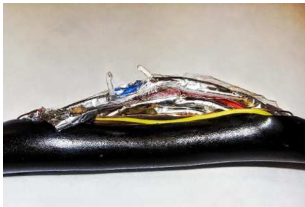
Fig. 2.3 Falla en cable debido a fracturas o cortes por el mal manejo
