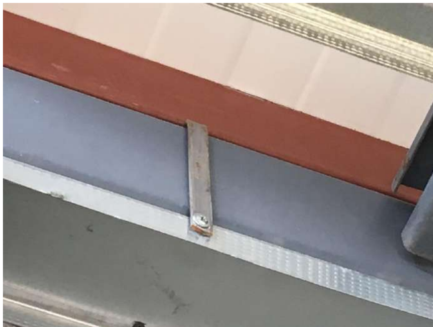
FIGURA 38. Anclaje sin perforar en estructura base de acero de refuerzo (Foto tomada por el autor).
