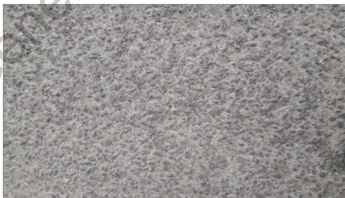
Figura 1.1 Rugosidad en un pavimento asfáltico.
