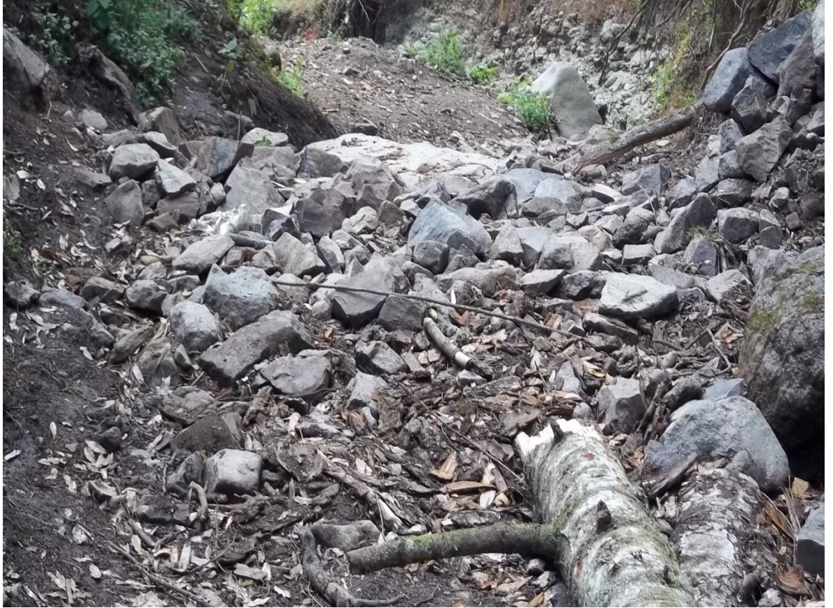
Figura 26. Falla causada a una presa de Piedra Acomodada
