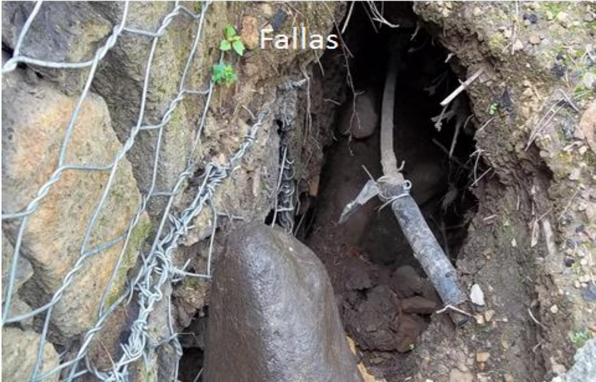
Figura 24. Falla causada a una presa de Gavión
