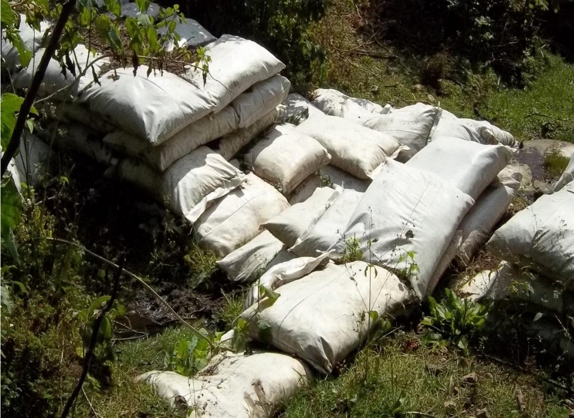
Figura 23. Falla causada a una presa de Geocostales
