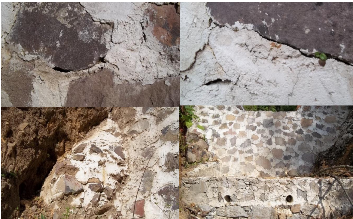
Figura 25. Fallas presentadas en una presa de mampostería
