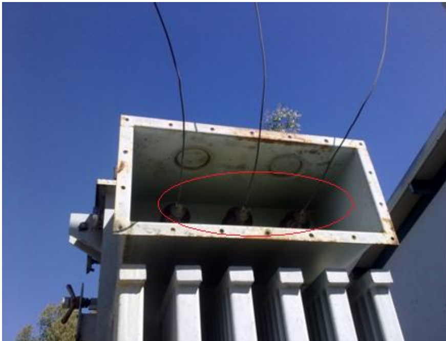
Figura 8. Terminales principales del Transformador 1.
