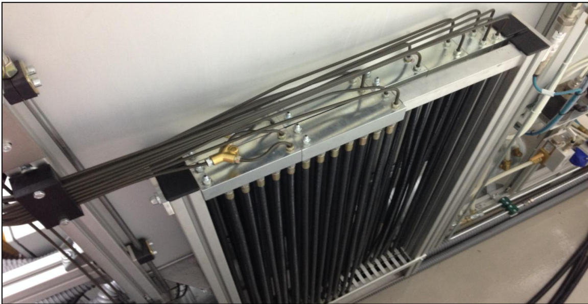
Figura 5-12 Conexión de conjuntos de mangueras.
