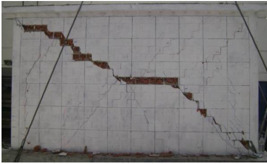
Figura 31. Estado de daño en muro sin refuerzo (Flores et al., 2012).
