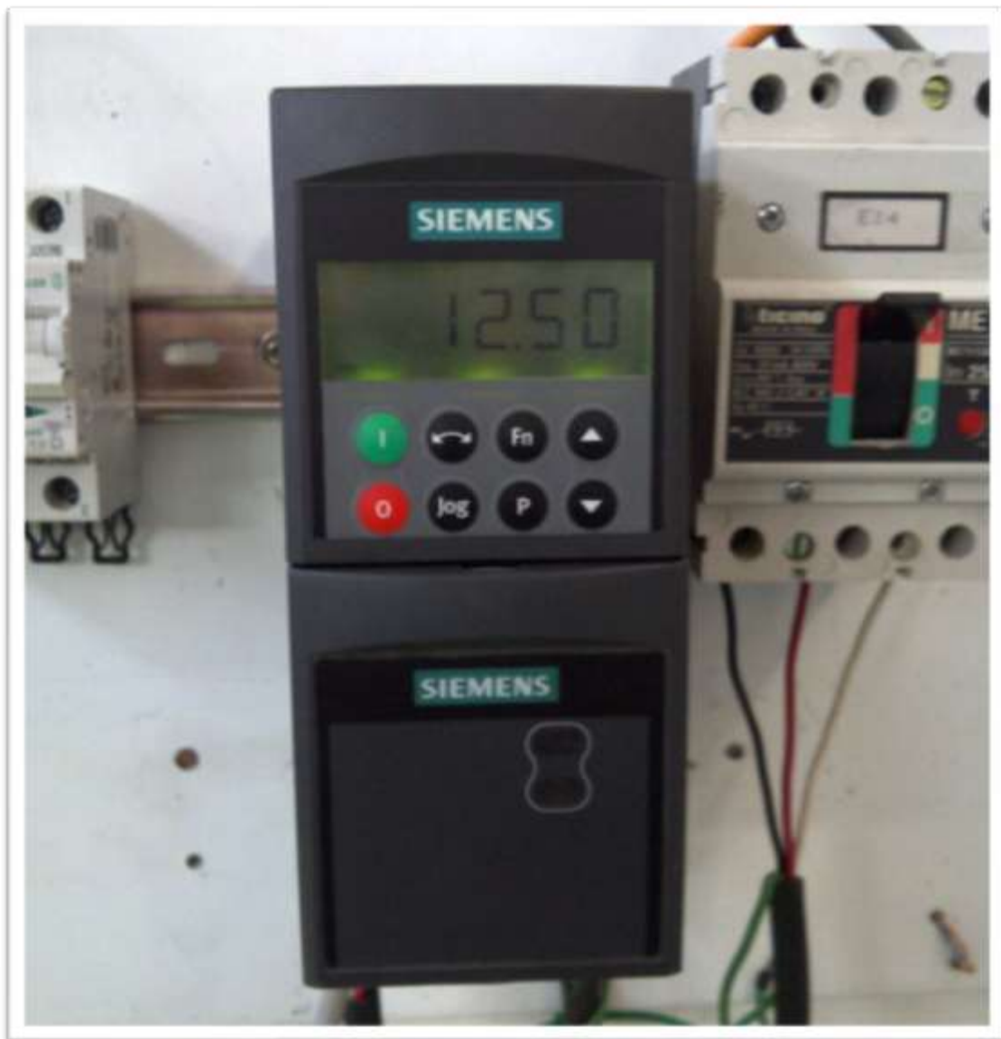
Figura 3.20. Variador de frecuencia
