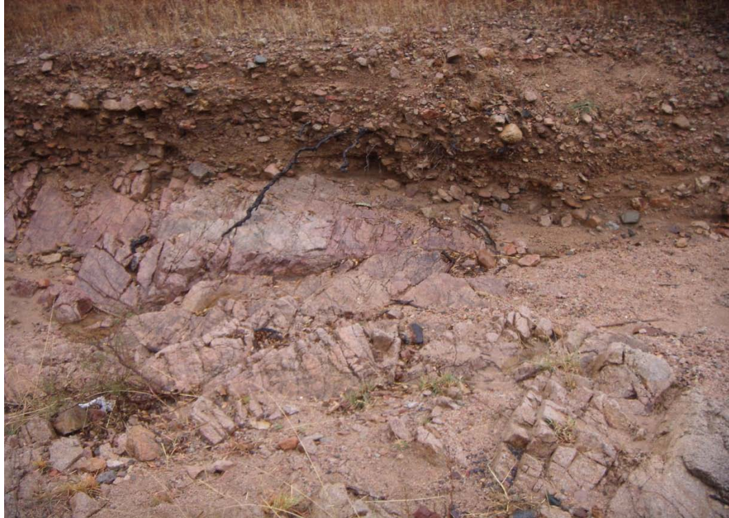
Foto 5.6. Acumulación de material gravo-arenoso y roca fragmentada encima de la roca, sobre una de las márgenes del arroyo. Se retirará para apoyo de gaviones en roca sana.
