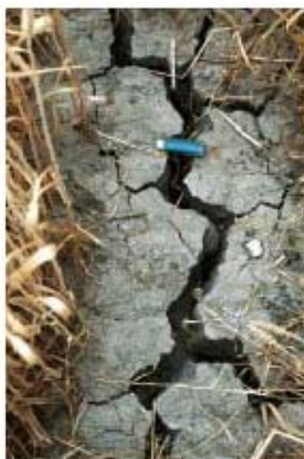
Fig. 1.2. Grietas en la superficie en época de estiaje.
