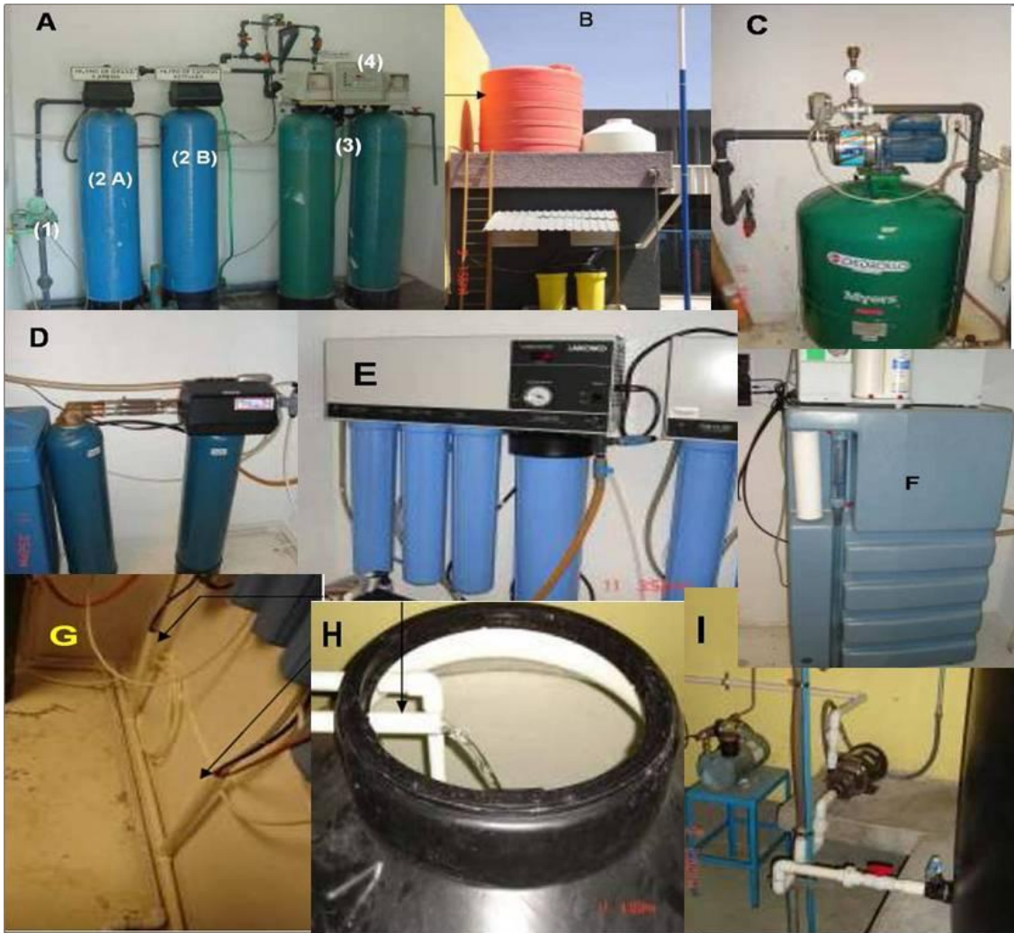
Figura 4.9. Sistema de recirculación del agua de rechazo del sistema de osmosis inversa a la planta desmineralizadora de agua de pozo del CENAM. Las imágenes muestran las etapas del sistema. A. planta desmineralizadora de agua. B. tanque almacén del agua desmineralizada para uso de metrología de materiales. C. hidroneumático empleado para bombear agua desmineralizada al suavizador de agua. D. suavizador y filtros de grava, arena y carbón activado que bi-desmineralizan y filtran el agua que proviene de la planta desmineralizadora de agua de pozo. E. purificadores de ósmosis inversa están compuestos por cartuchos con filtros que atrapan micro partículas de sales. F. cisterna para almacenar agua filtrada de los purificadores de ósmosis inversa. G. tubería del agua de rechazo. H. cisterna para almacenar agua de rechazo. I. sistema de bombeo.
