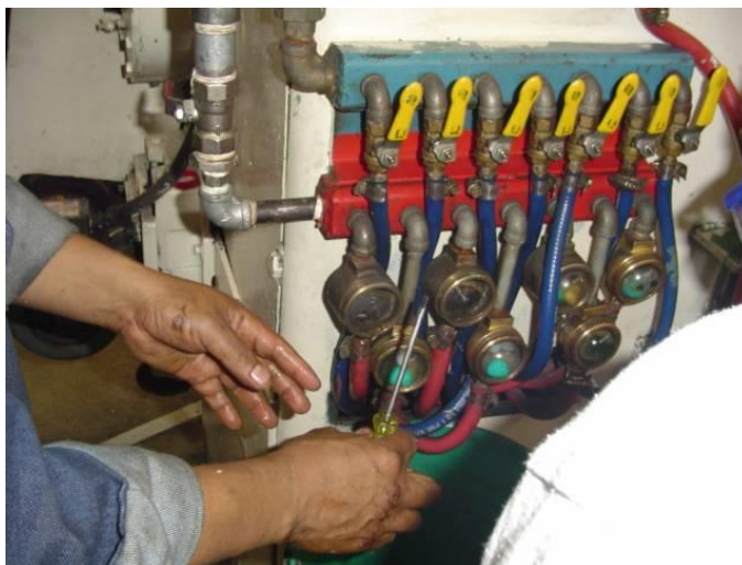
Fig. 58. Sistema de enfriamiento.
