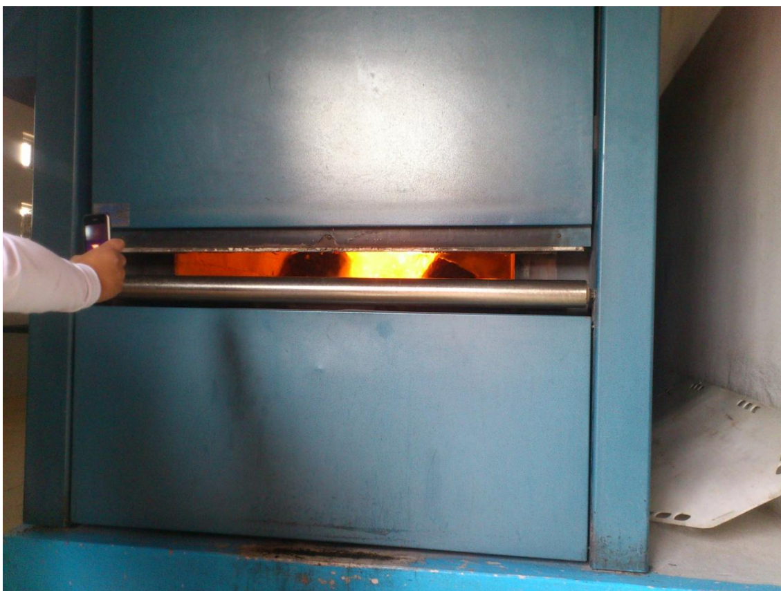
Fig. 15 Proceso de incineración de la cascara de arroz, horno trabajando con el quemador principal.
