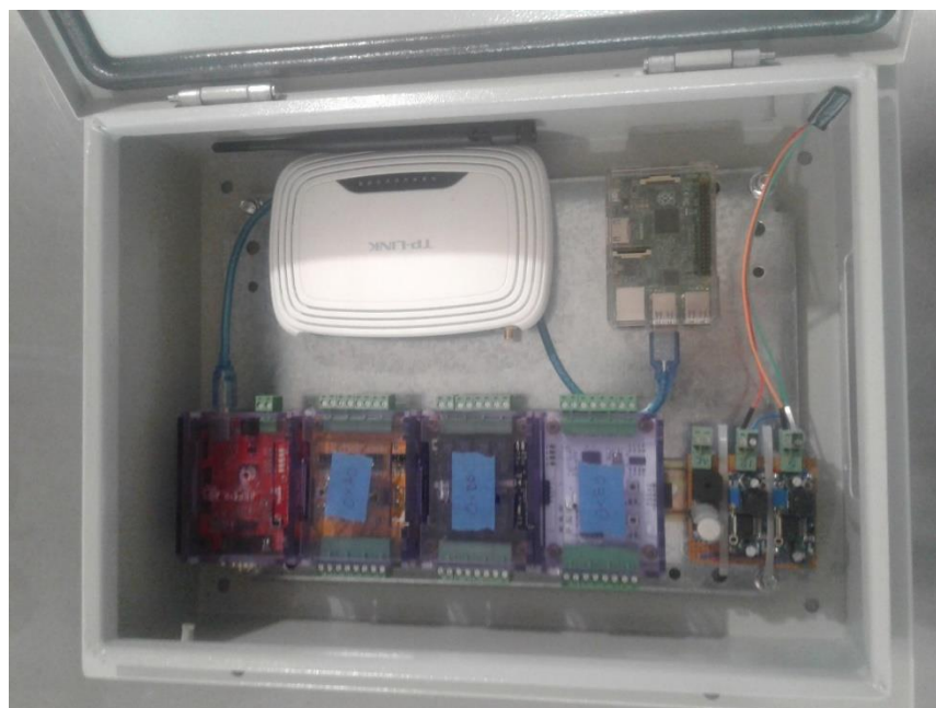
Figura 3.28. Gabinete con el sistema SCADA.
