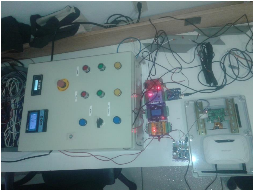
Figura 4.10. Sistema SCADA trabajando en conjunto con el panel de control de la máquina de fertirriego.
