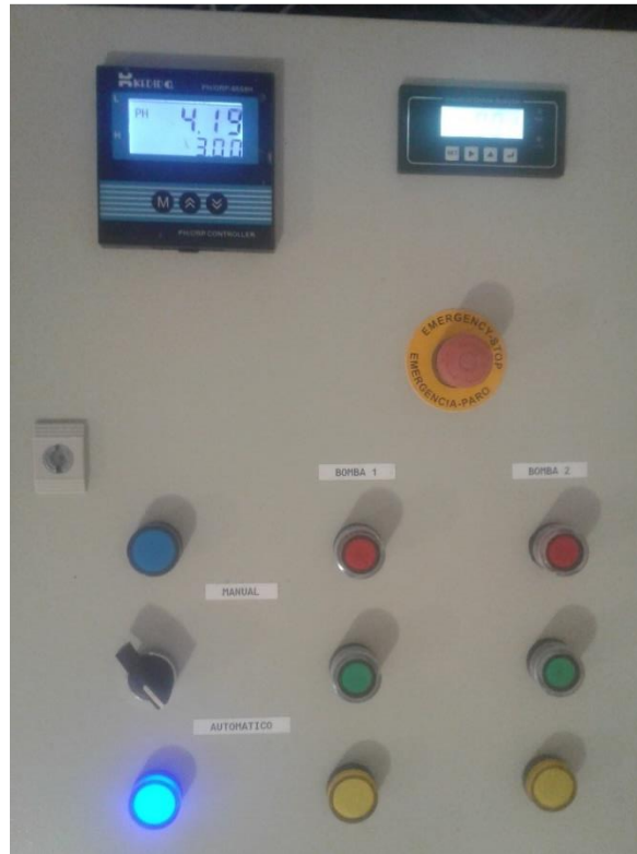
Figura 3.10. Vista externa del gabinete de control para el cabezal de la máquina de fertirriego.
