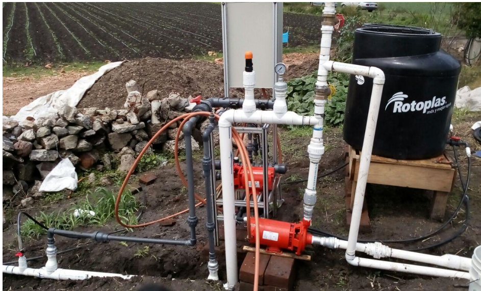
Figura 4.14. Máquina de fertirriego automática instalada en Romita, Gto.
