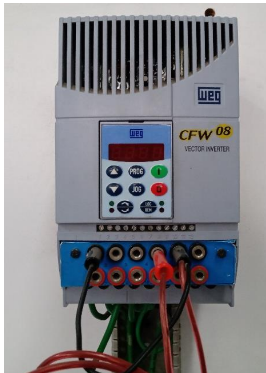
Figura 57 Variador de frecuencia (Autoría propia)
