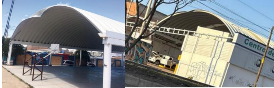
Figura 9. Fallas por pandeo local en arcotechos.
