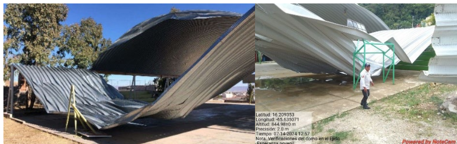
Figura 11. Colapso de arcotechos por fuertes vientos en escuela en Chihuahua (derecha) y en Chiapas. (izquierda) Fuente: Google (2025).
