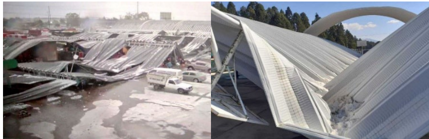
Figura 10. Colapso de cubiertas en bodegas de central de abastos CDMX por granizo (izquierda) y colapso de cubierta en escuela por acumulación de granizo Texcaltitlán, Edomex (derecha). Fuente: Google (2025).
