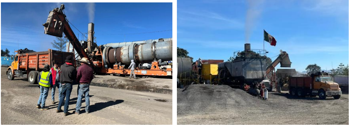
Figura 6-8 Planta de producción de mezcla asfáltica "Pitula".
