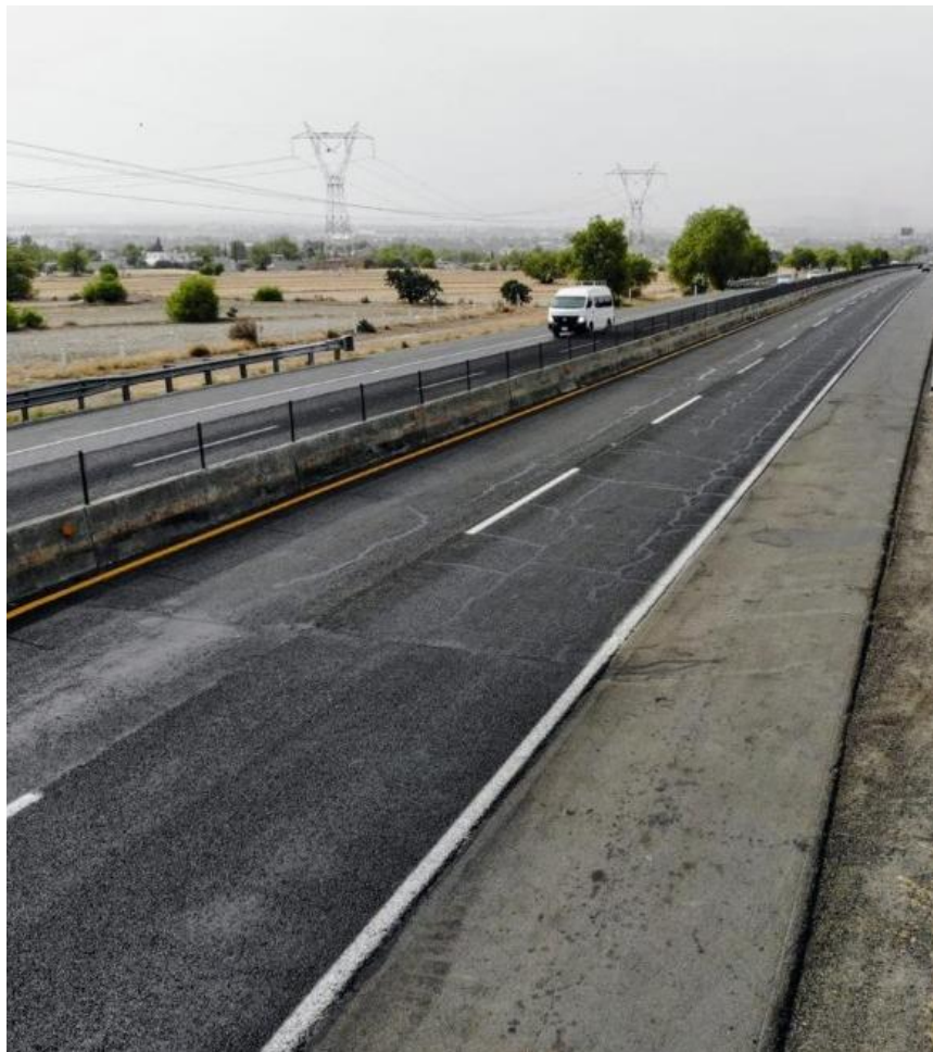
Figura 6-18 Reflexión de grietas en el tramo de interés previas a la intervención.
