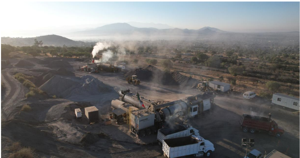
Figura 6-22 Planta de producción de mezcla asfáltica “La Providencia”.
