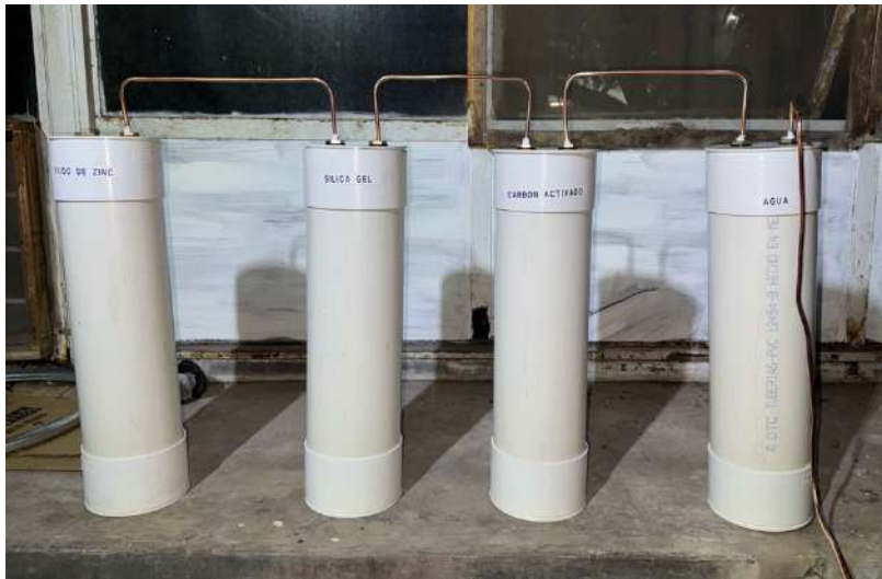
Figura 24. Trampas para biogás montadas (Fuente propia)
