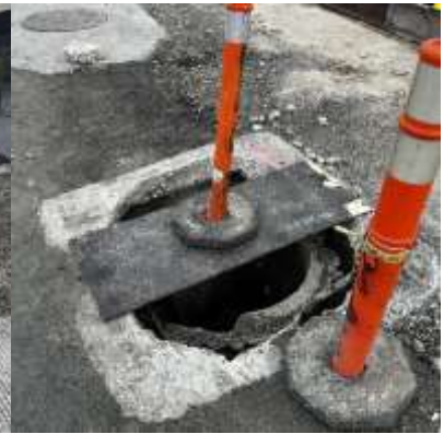
Figura 148. Pérez, P. I., (2024) Coladera abierta [jpg], Querétaro.
