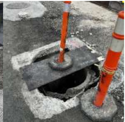
Figura 148. Pérez, P. I., (2024) Coladera abierta [jpg], Querétaro.
