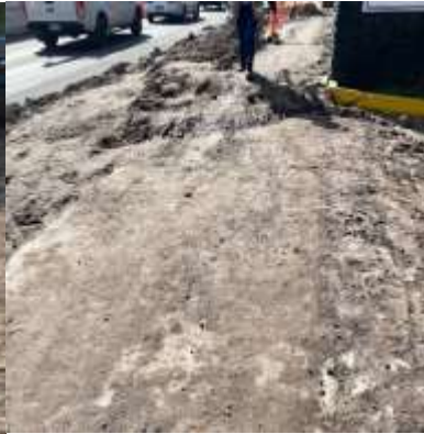
Figura 66. Pérez, P. I., (2023) Banqueta destruida [jpg], Querétaro.
