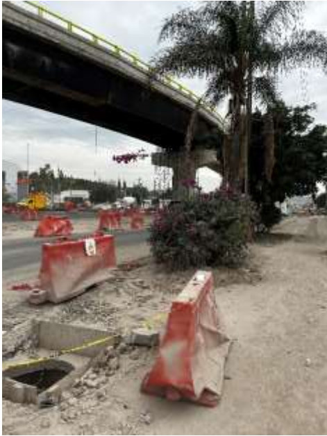
Figura 19. Pérez, P. I., (2023) Coladera [jpg], Querétaro.
