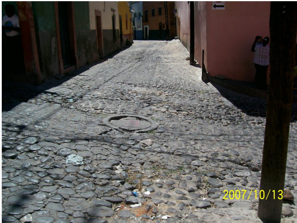
Detalle del mal estado de los brocales
