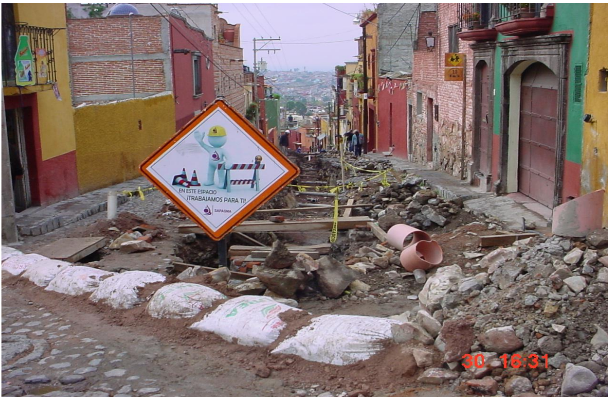
Instalación de costales con arena para desviar las aguas de lluvia que provocaron un atraso en la obra.
