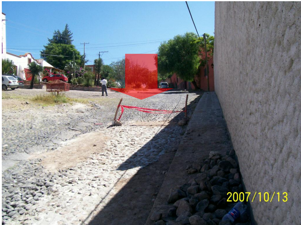
Detalle de las constantes reparaciones
