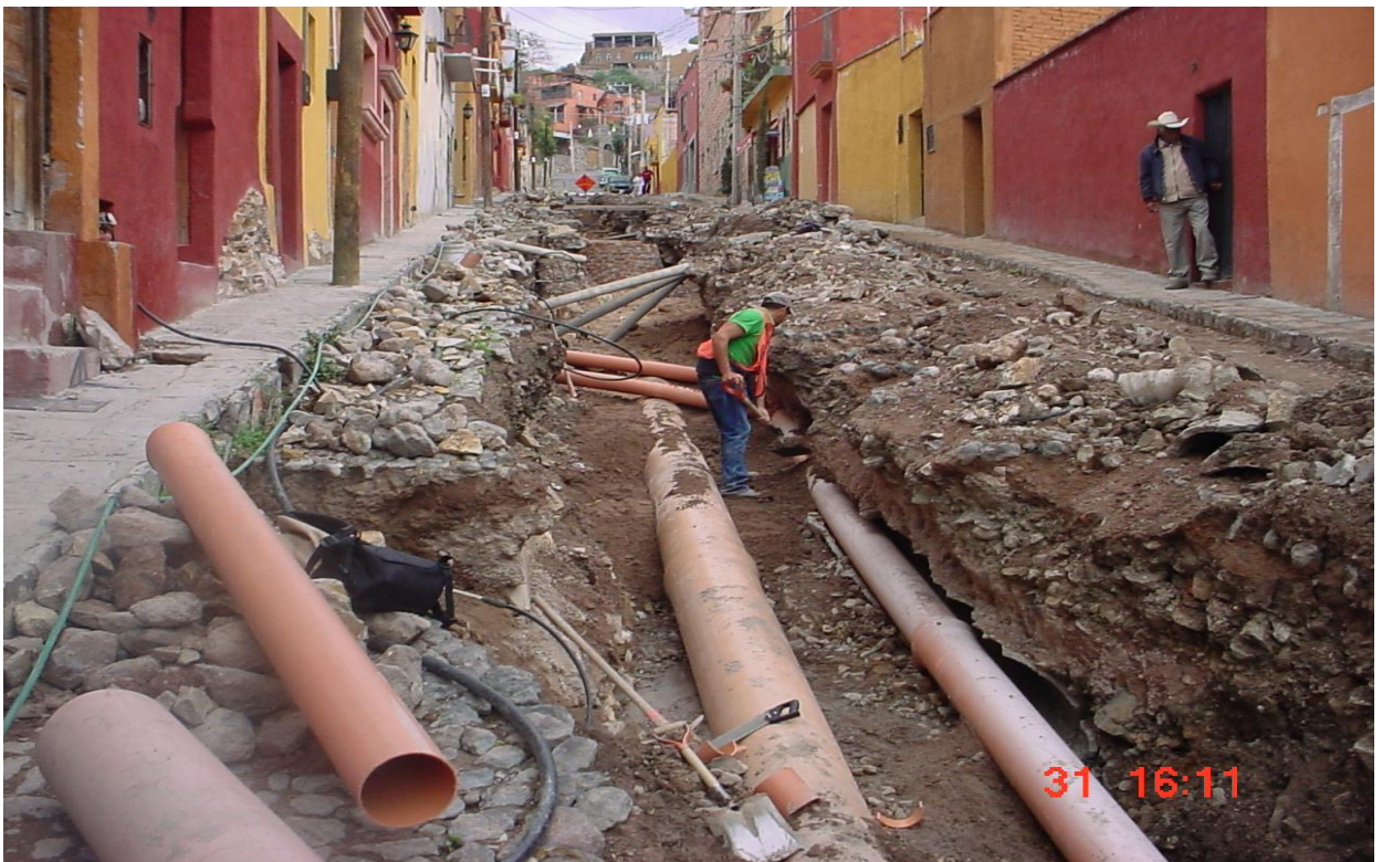
Vista del nuevo colector de 45 cm (izquierda) para dar continuidad a las descargas de aguas negras provenientes de la parte alta de la ciudad, a la derecha se aprecia la nueva línea de 25 cm para descargas de aguas negras de las calles de Cuesta de San José y Homobono.
