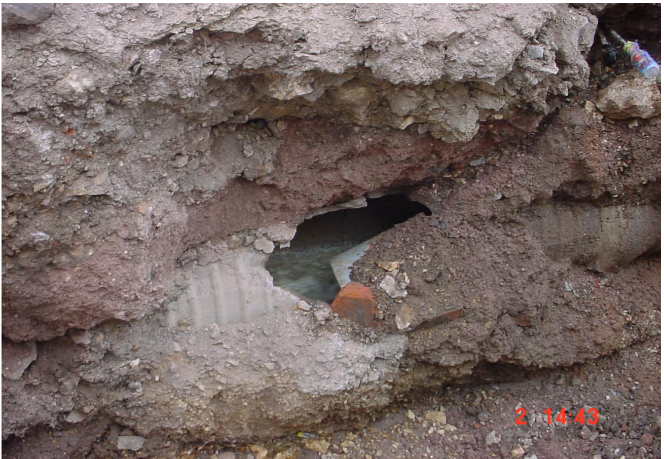
Estado en el que se encontraba el colector anterior de concreto que tenía un tiempo de trabajo de aproximadamente 40 años y presentaba varias fugas en distintas partes de la línea o en algunos tramos ya no existía el colector.
