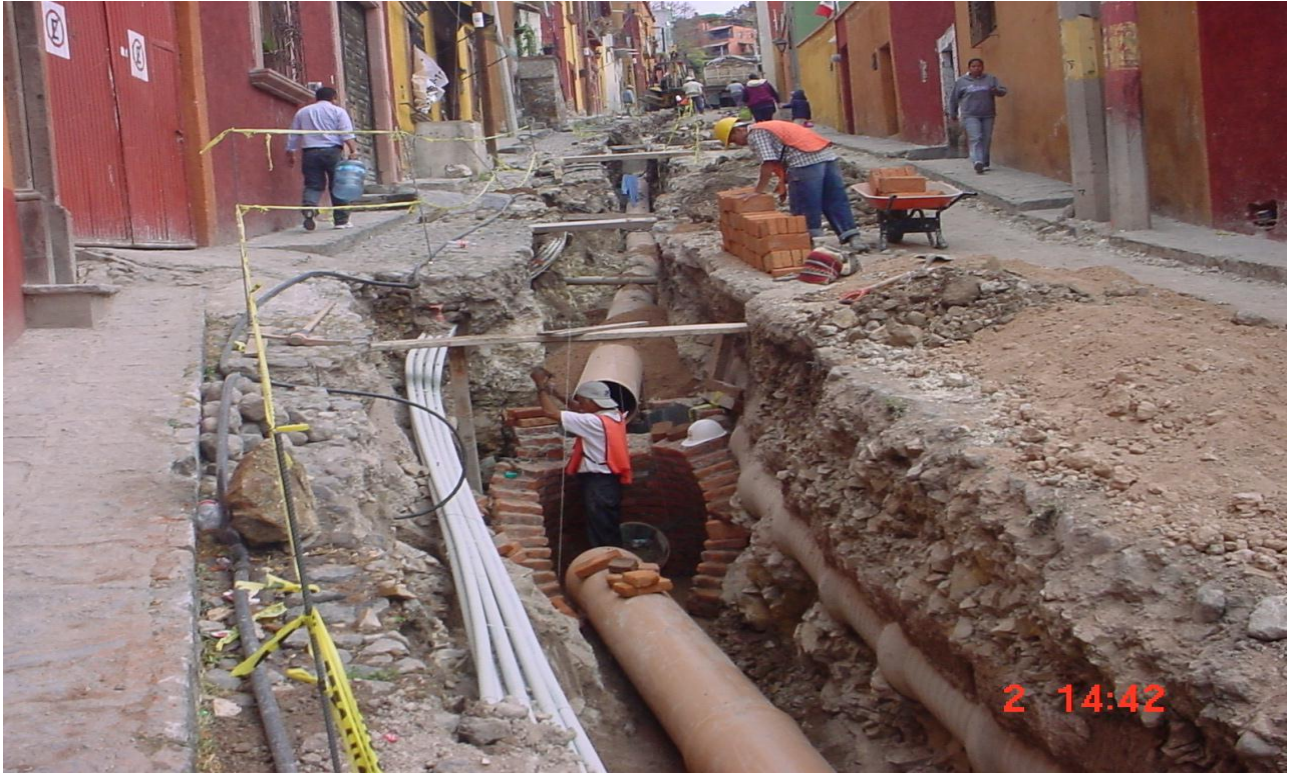
Instalación del colector de aguas negras de 45 cm. De PVC sanitario serie 25 y construcción de un pozo de visita con caída adosada. Se puede apreciar a un lado del colector la línea antigua de drenaje de 30 cm de concreto simple.
