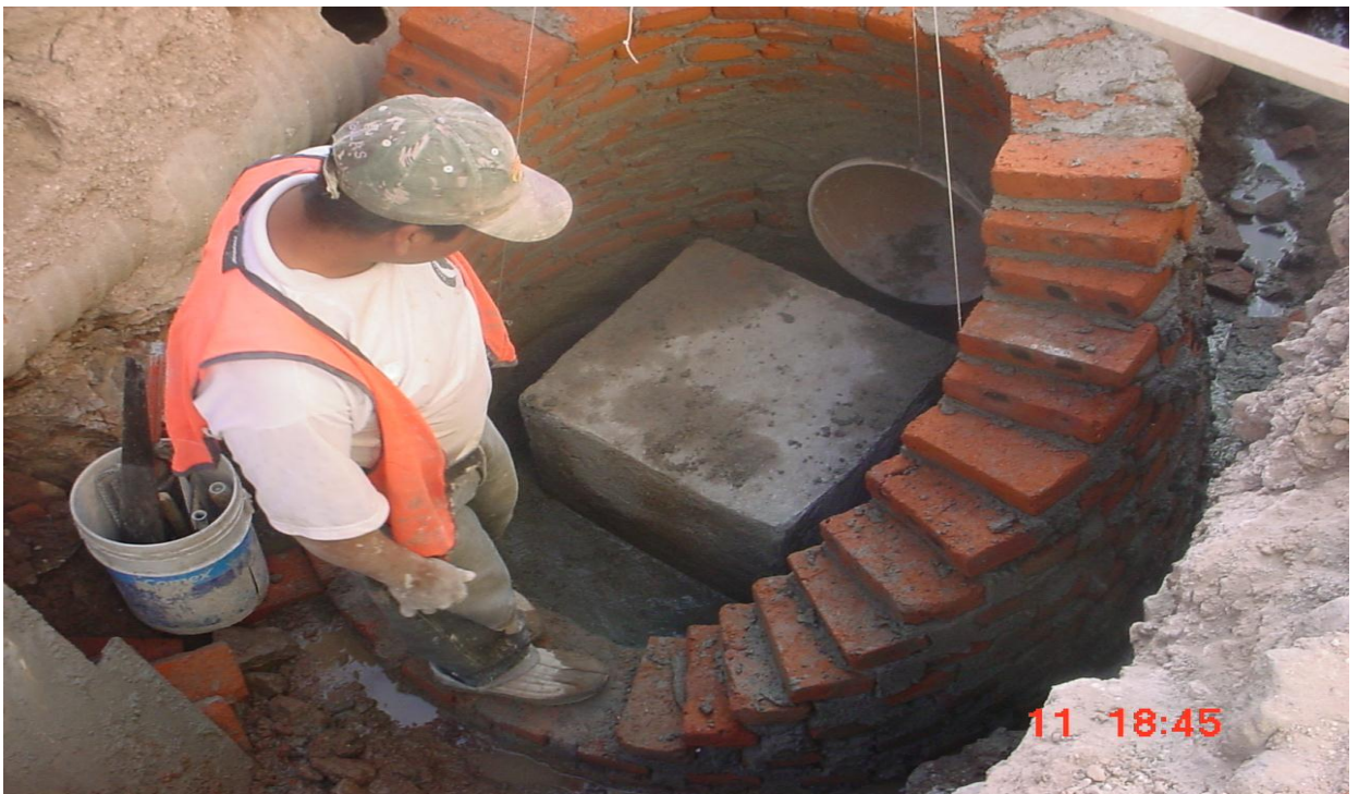
Pozo de visita con lavadero de concreto.
