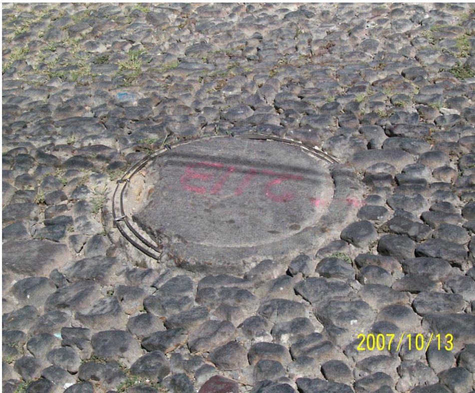
Existencia de brocales y tapas en mal estado
