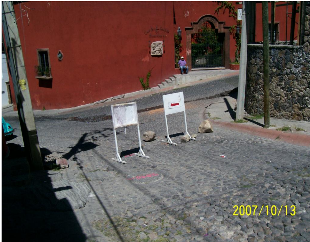
Continuidad del colector
