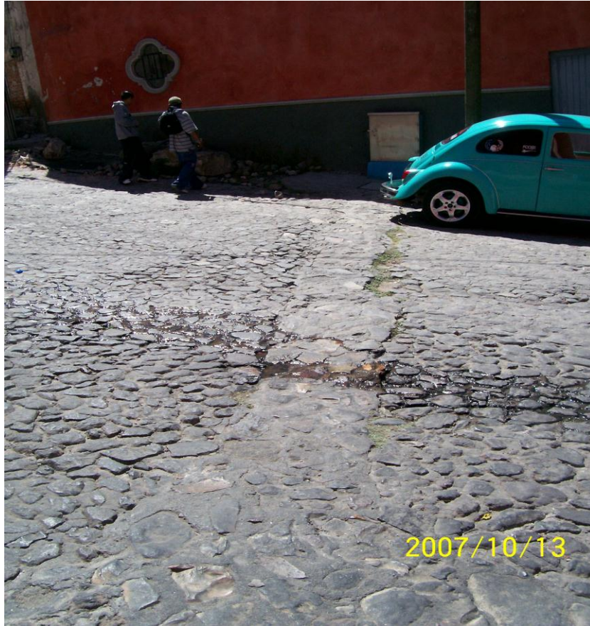
Presencia de fugas de agua potable
