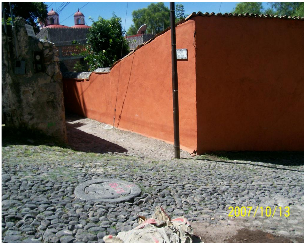
Presencia de filtraciones y humedades
