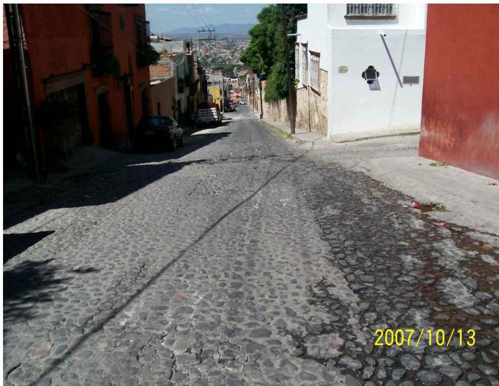
Vista de la existencia de fugas de agua
