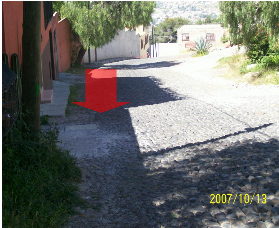
Detalle de las constantes reparaciones
