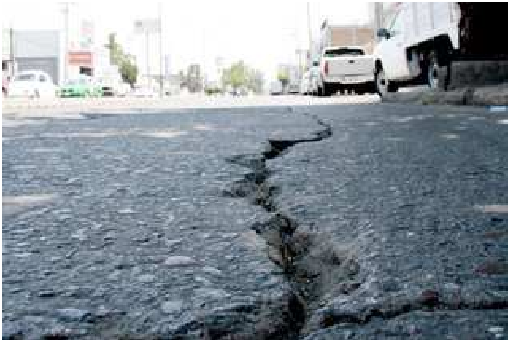
Figura 4.6 Fisura por fatigamiento.
