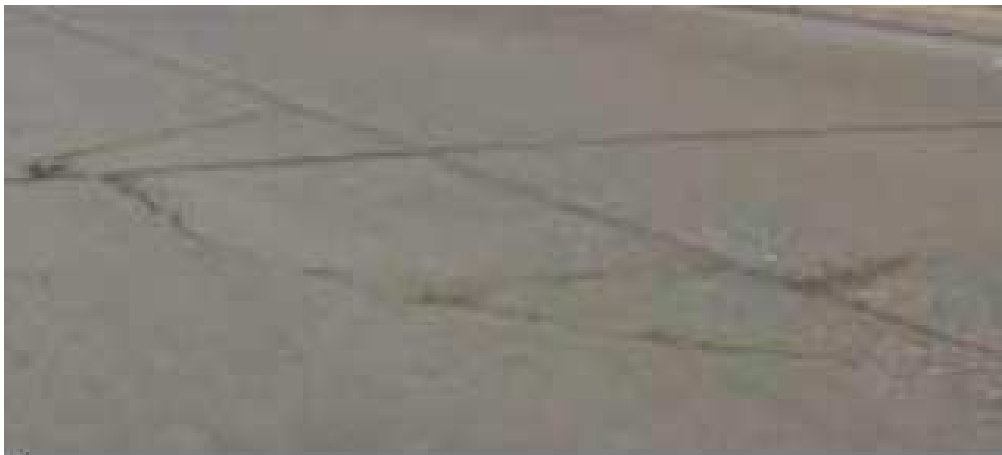
Figura 6.4. Fisura de esquina.
