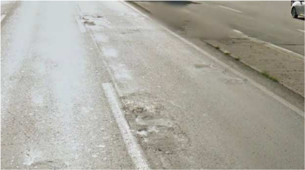
Figura 5.9 Deterioro de parches.
