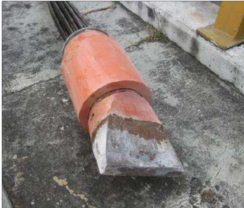
Figura 1. 9 Elemento de anclaje del tirante 1, semi arpa 5 que falló
