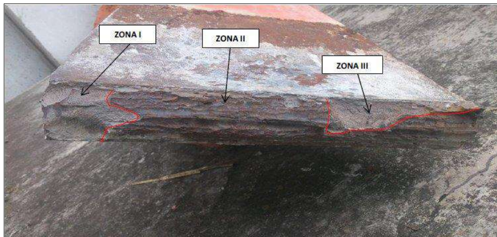
Figura 1. 10 Sección de fractura del elemento de anclaje del tirante 1, semi-arpa 5
