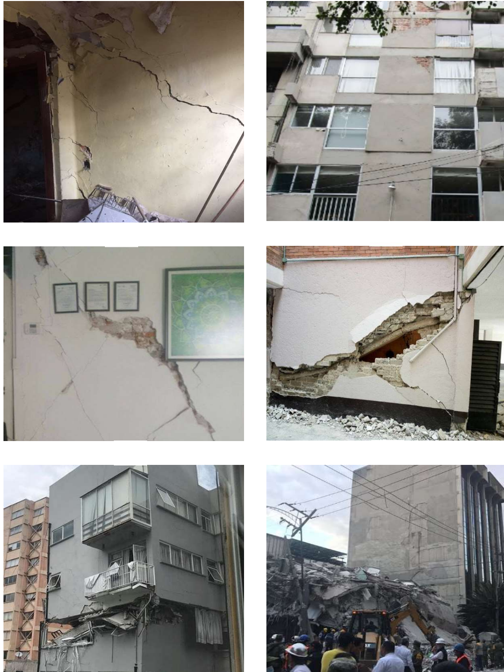
Figura 4.2 Daños en inmuebles con caracterización de daños para: a) Estructuras débiles sin Ingeniería b) Grietas en acabados y elementos no estructurales c) Grietas pequeñas en muros, trabes y columnas d) Grietas grandes en muros, trabes y columnas e) Colapso de pisos superiores f) Colapso de la planta baja o toda la estructura (ERN, 2018)
