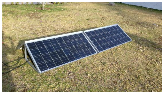
Figura. 3.1.1.1 paneles solares KYOCERA KC130TM
