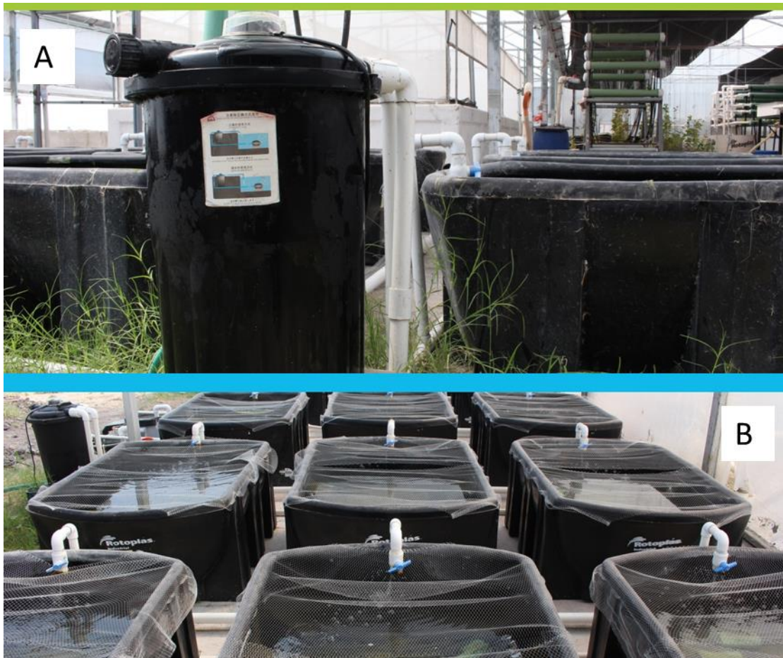
Figura 8. Filtro canister con UV para el tratamiento del agua de los sistemas de recirculación (A) y regreso de agua a través de válvulas
