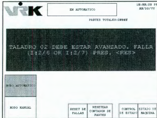
5.9. Mensaje central con falla en panel view. (Pantalla principal)
