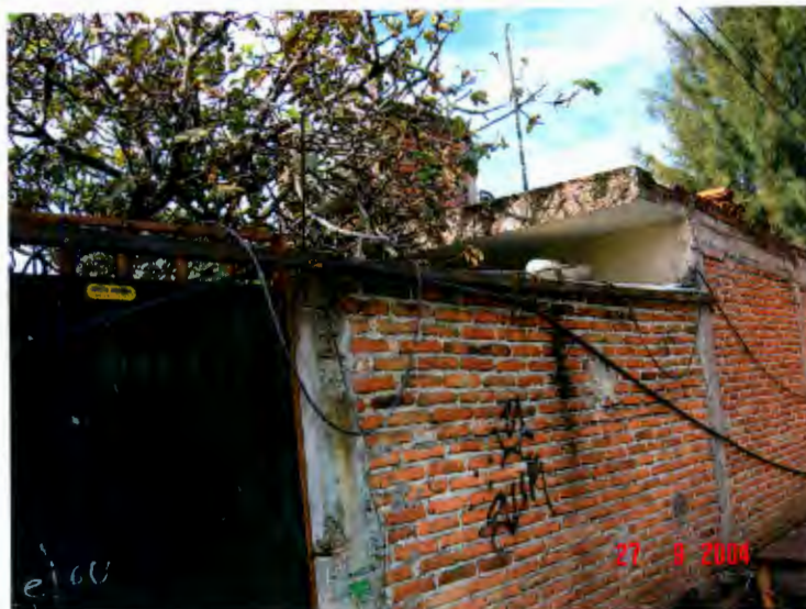
Figura 6.21 Refuerzo provisional en barda mal estructurada, por medio de cerramiento metálico.
