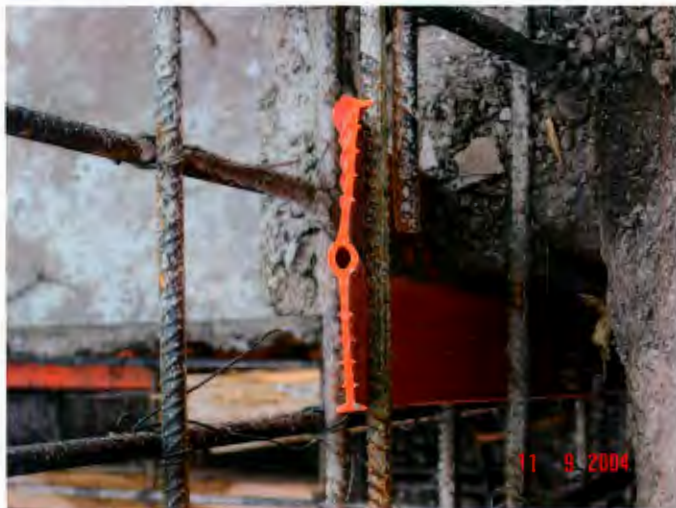
Figura 6.37 Vista de banda de P.V.C en junta fría.
