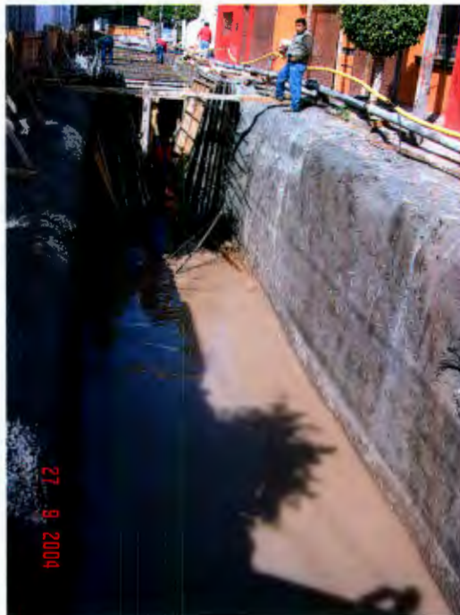
Figura 6.28 Vista de inundación en el dren durante su construcción.
