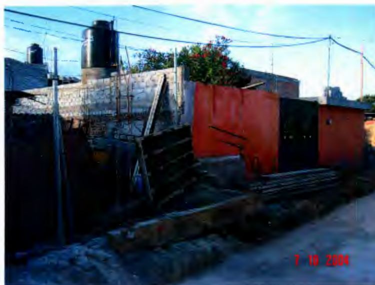
Figura 6.22 Barda demolida por representar alto riesgo estructural y bajo valor de pérdida.
