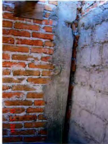
Figura 4.10 Vista de barda con cuarto adosado a barda, sin liga.
