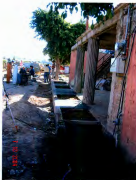
Figura 6.39 Vista de inicio de los trabajos de construcción de guarniciones y banquetas en Privada de la Flor.
