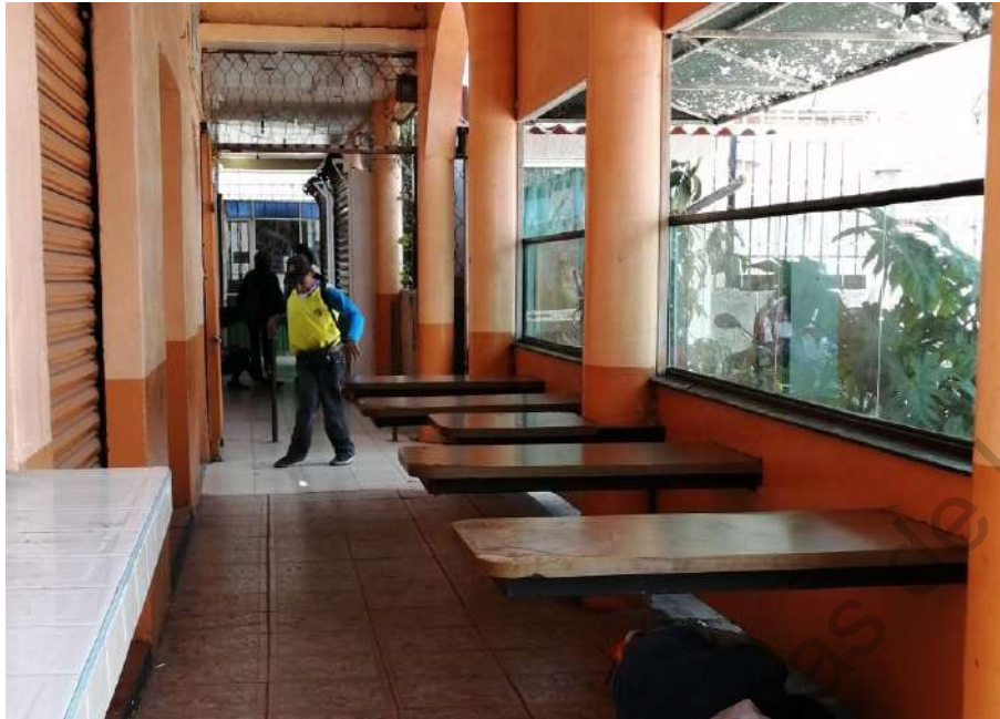
Figura 54. Locales cerrados en pasillo exterior junto al estacionamiento.
