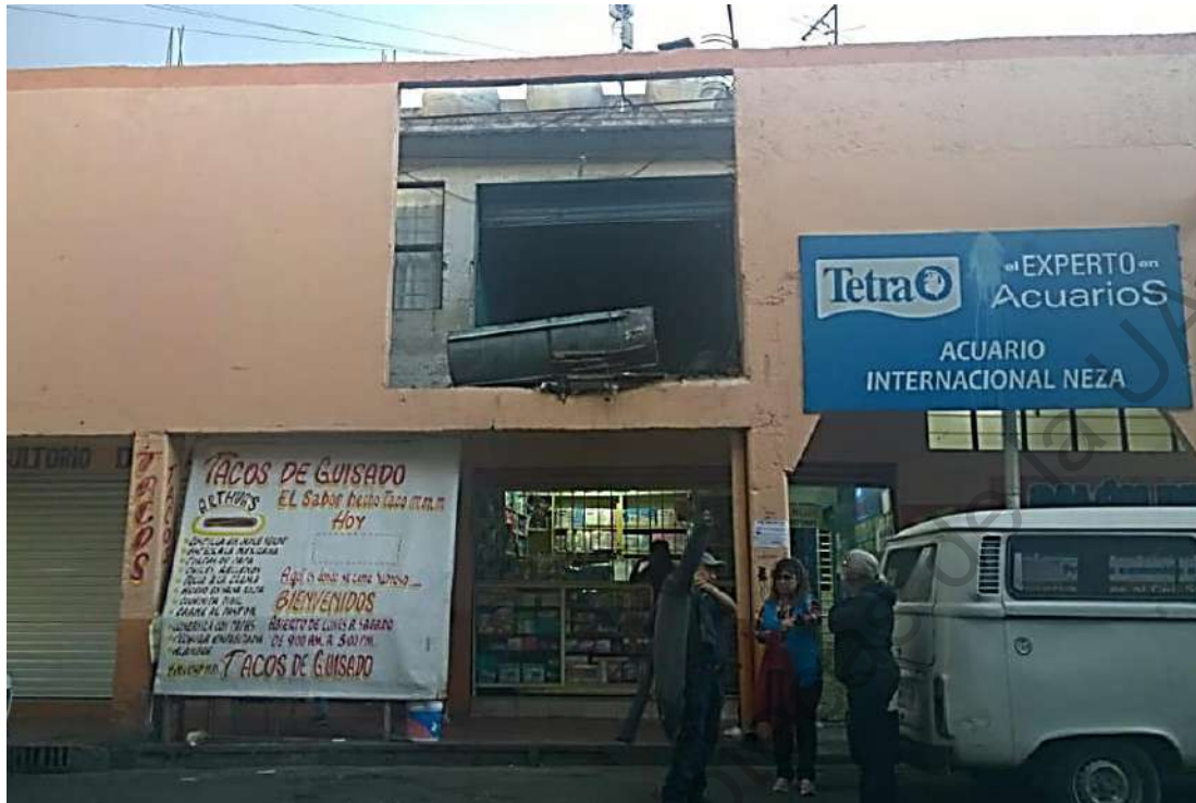
Figura 39. Depósito de basura en planta alta.
