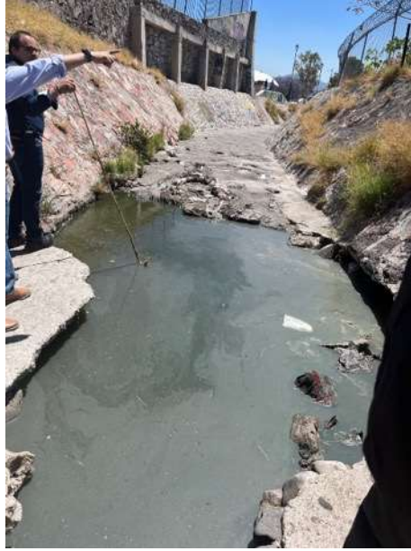
Fig. 8 “Socavón en cauce” (Elaboración Propia)
