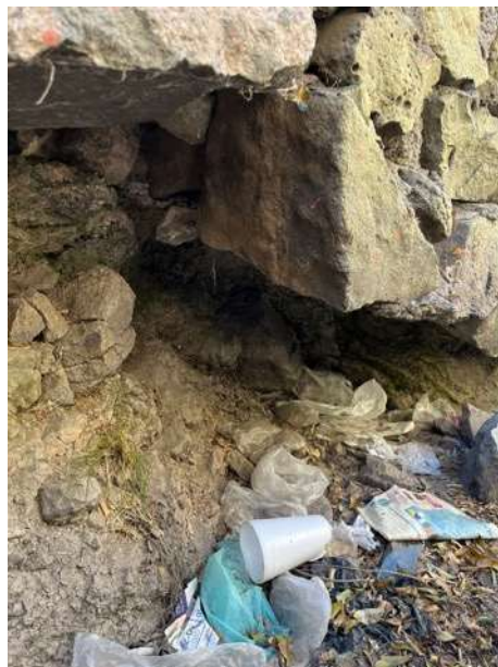
Fig. 16 “Desbordamiento inferior de las paredes del Dren Peñuelas” (Elaboración propia)
