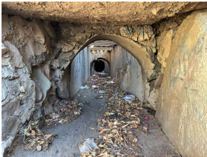
Fig. 15 “Residuos transportados de la tubería del dren Peñuelas” (Elaboración propia)
