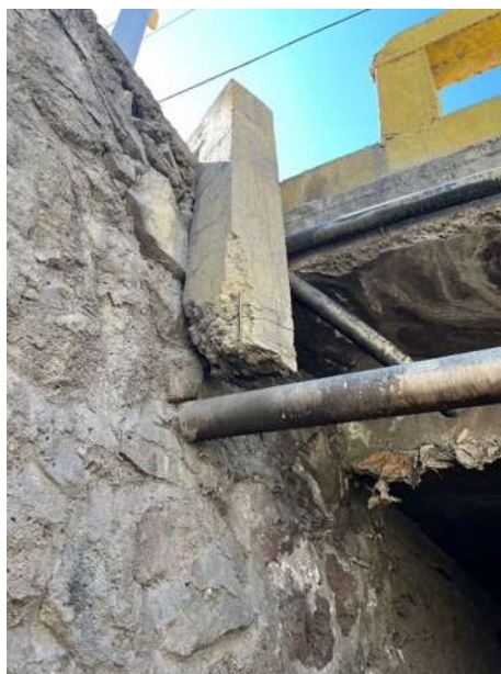
Fig. 6 “Estructura de concreto ineficaz” (Elaboración propia)
